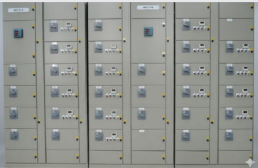
陆基配电设备
